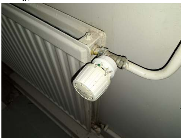
48. Termostaatit on uusittu
