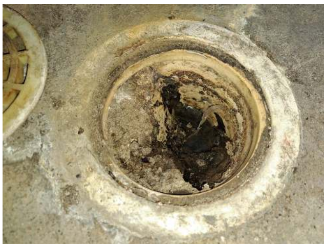
53. Teknisen tilan lattiakaivo
